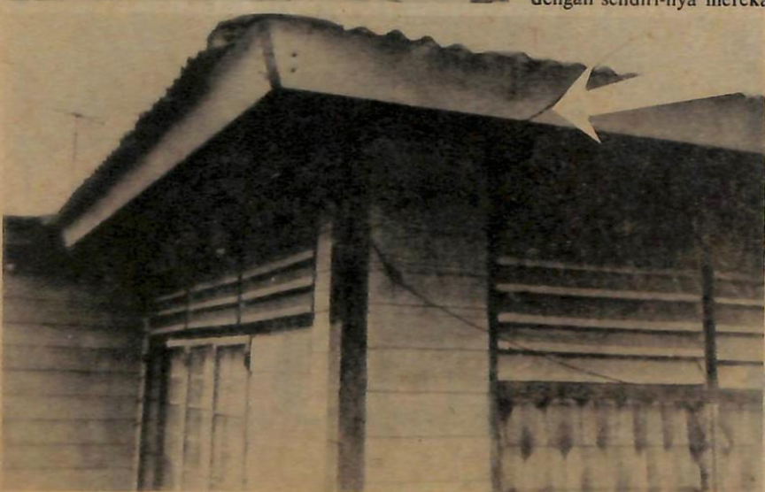
PENYAMBONGAN dan tambahan pemasangan yang tidak mendapat kebenaran dari Jabatan Perkhidmatan2 Letrik seperti kelihatan gambar2 atas ada-lah tidak di-benarkan.
