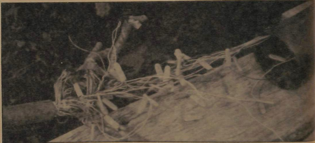
SAMBUNGAN 'wire' pada kabel telefon ini juga tidak terlepas dari menjadi mangsa perosak-perosak yang tidak menghargai awam yang disediakan oleh kerajaan.
